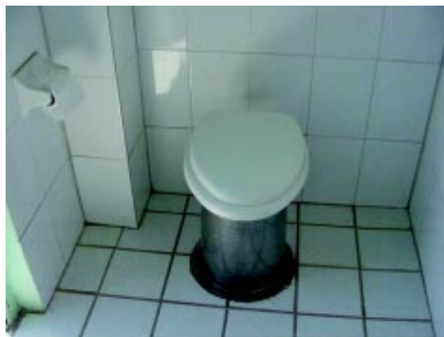
Figura 2 Las letrinas deben estar construidas con materiales fáciles de limpiar como los que se observan.
