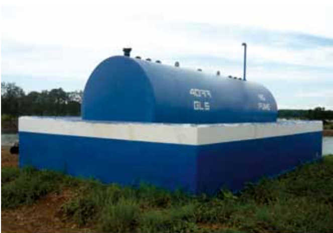
Figura 17. Depósito de combustible debidamente rotulado y con una fosa de seguridad para contener derrames. Foto cortesía del Ing. C. Lara.
