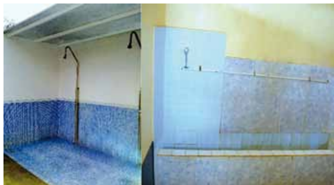
Figura 6b. Instalaciones de duchas (izquierdas) y orinales (derecha) para trabajadores de una granja camaronera. Las duchas permiten eliminar el agua salada luego las jornadas en los estanques y lavarse sustancias que podrían ser irritantes como la cal o algunos fertilizantes. Fotos cortesía del Ing. C. Lara y del Dr. J. Cuéllar-Anjel.
