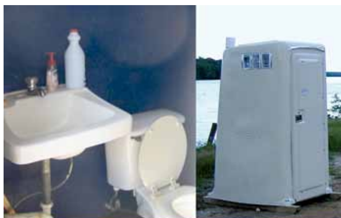
Figura 6c. Instalaciones completas de lavamanos y servicio sanitario para los empleados de una granja camaronera, equipado con elementos de limpieza y desinfección (izquierda). Letrina portátil ubicada cerca de las áreas de descanso del personal de campo en una granja camaronera (derecha). Fotos cortesía del Lic. M. De León y del Dr. J. Cuéllar-Anjel.
