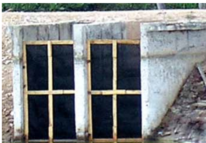
Figura 52b. Marcos de madera con filtro de malla negra, instalados en una estructura de salida de un estanque en una granja camaronera. El propósito es evitar la fuga de camarones durante los recambios de agua en el estanque. Foto cortesía del Dr. J. Cuéllar-Anjel.
